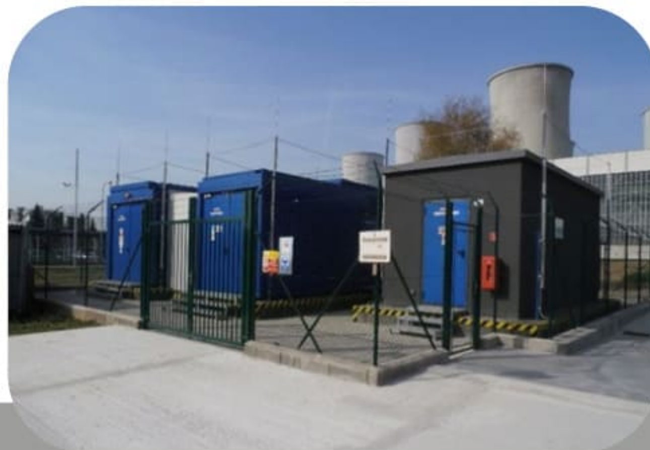
Jaslovské Bohunice 1.2 MW / 6 kV
