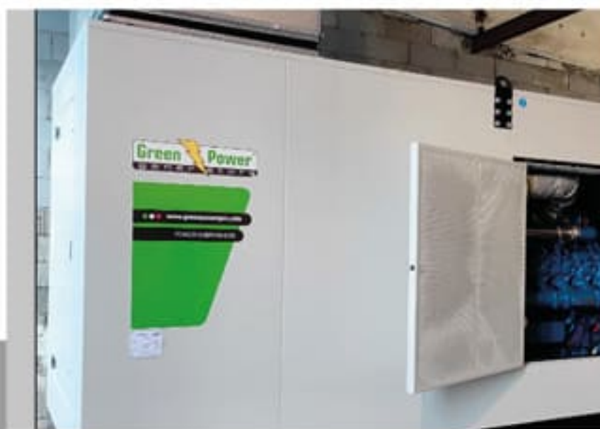
Lednické Rovne 1400kVA / 1120 kW
