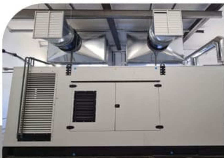
Považská Bystrica 1400kVA / 1120 kW
